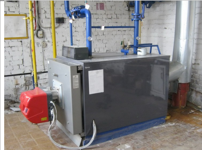
Рисунок 1.2.13 – Котельная с. Яковлевское. Котел Beretta Novella
