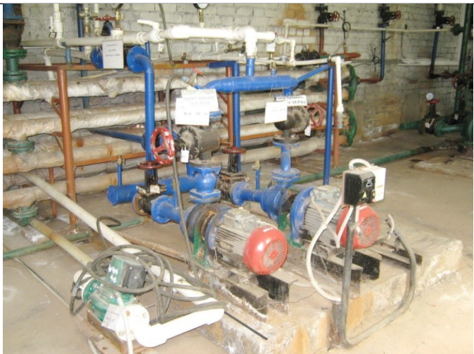
Рисунок 1.2.17 – Котельная д. Некрасово. Насосы ГВС.
