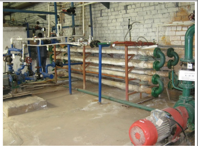
Рисунок 1.2.16 – Котельная д. Некрасово. Водоподогреватели.
