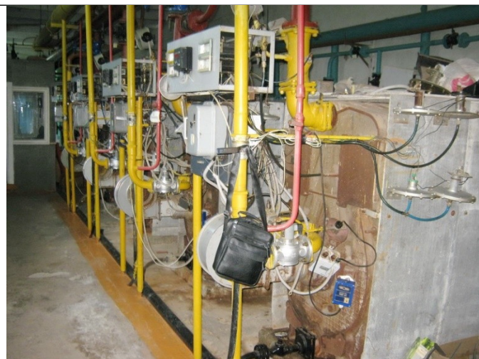
Рисунок 1.2.20 – Котельная с. Петрилово. Котлы Факел Г.
