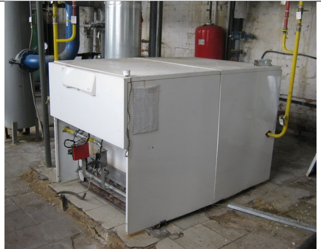
Рисунок 1.2.14 – Котельная с. Яковлевское. Котел Riello RTQ 418
