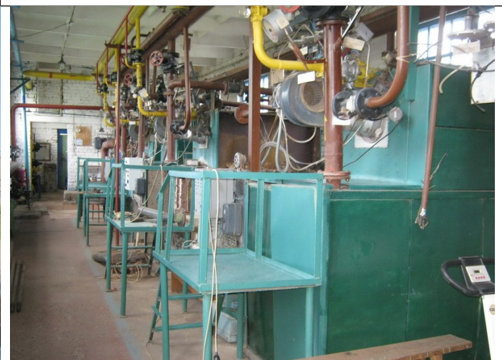
Рисунок 1.2.4 – Котельная с. Шунга. Котлы Братск 1Г
