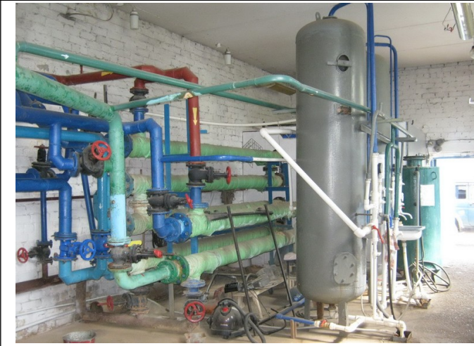
Рисунок 1.2.7 – Котельная с. Шунга. Водоподготовительная установка
