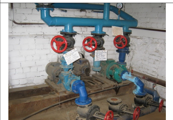
Рисунок 1.2.6 – Котельная с. Шунга. Насосы ГВС
