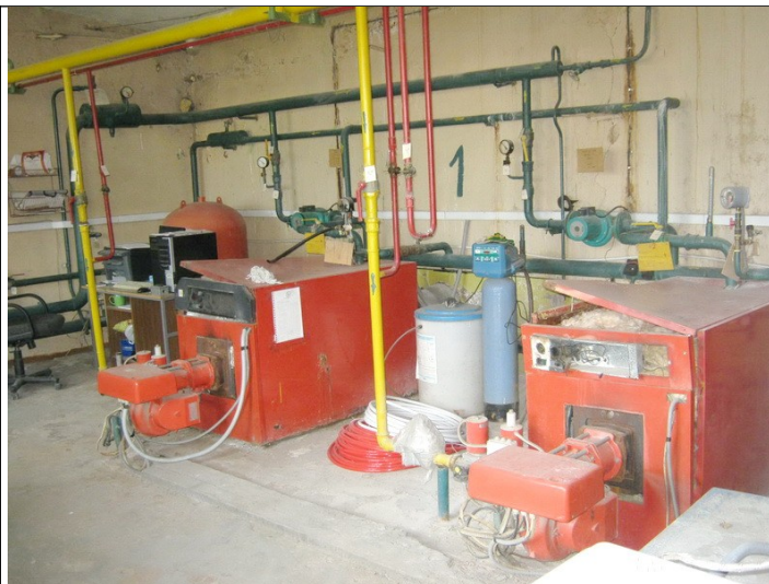
Рисунок 1.2.2 – Котельная школы с. Шунга. Котлы Kallard VR-12
