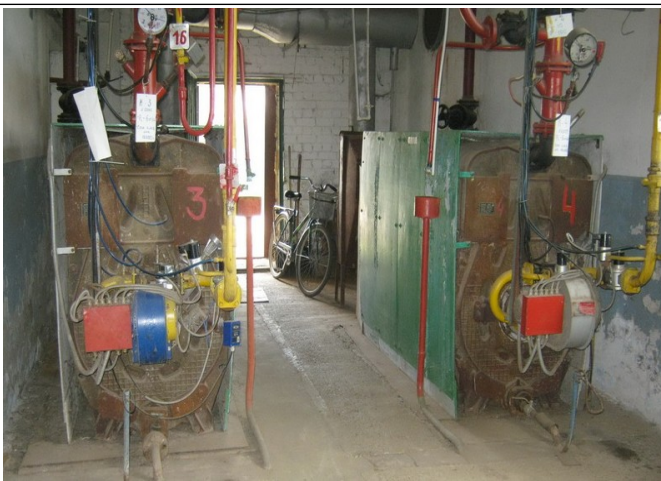
Рисунок 1.2.9 – Котельная с. Саметь. Котлы Факел Г.
