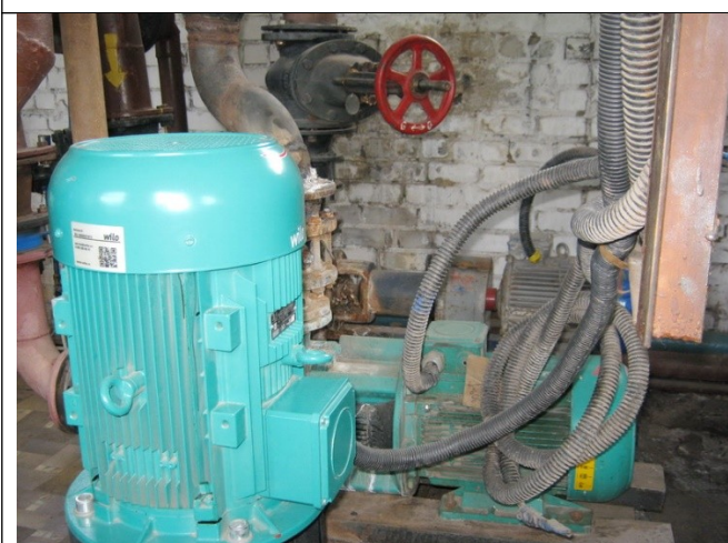
Рисунок 1.2.5 – Котельная с. Шунга. Сетевые насосы
