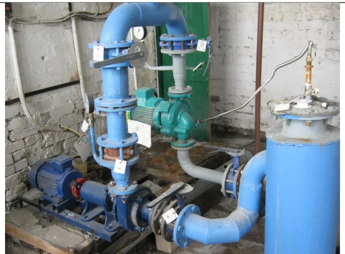
Рисунок 1.2.12 – Котельная с. Яковлевское. Сетевые насосы.
