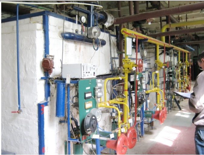
Рисунок 1.2.15 – Котельная д. Некрасово. Котлы КВН-1
