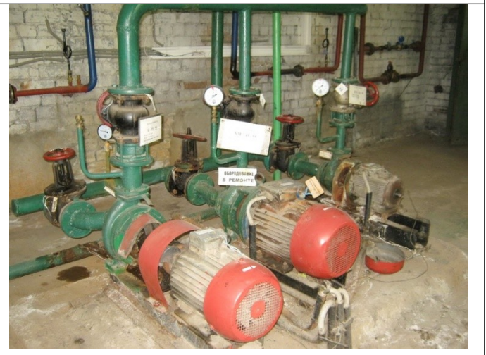
Рисунок 1.2.18 – Котельная д. Некрасово. Сетевые насосы.
