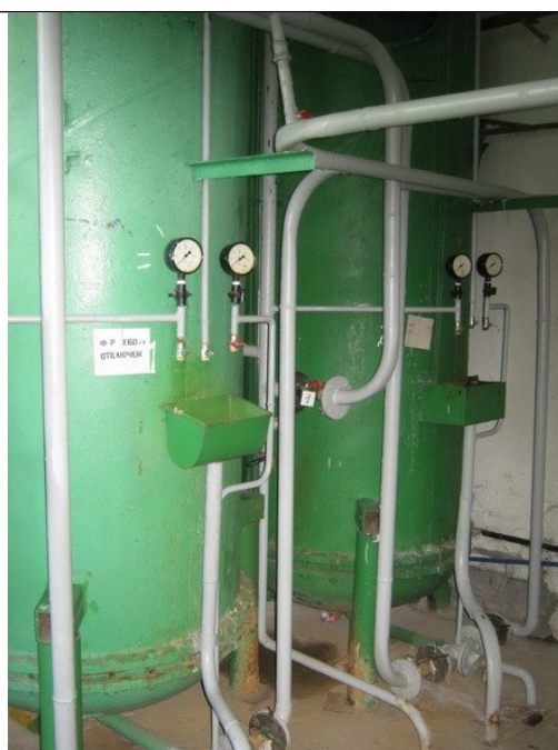
Рисунок 1.2.22 – Котельная с. Петрилово. Фильтры ВПУ
