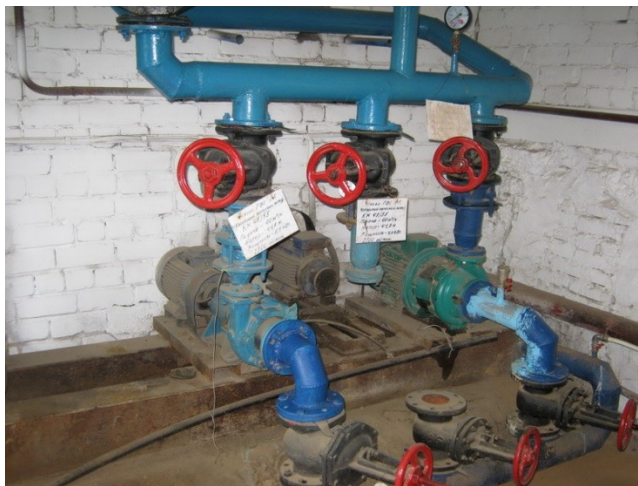
Рисунок 2.1.5 – Котельная с. Шунга. Сетевые насосы
