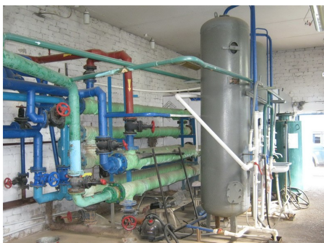
Рисунок 2.1.6 – Котельная с. Шунга. Насосы ГВС
