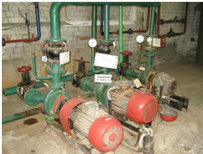
Рисунок 2.1.17 – Котельная д. Некрасово. Насосы ГВС.
