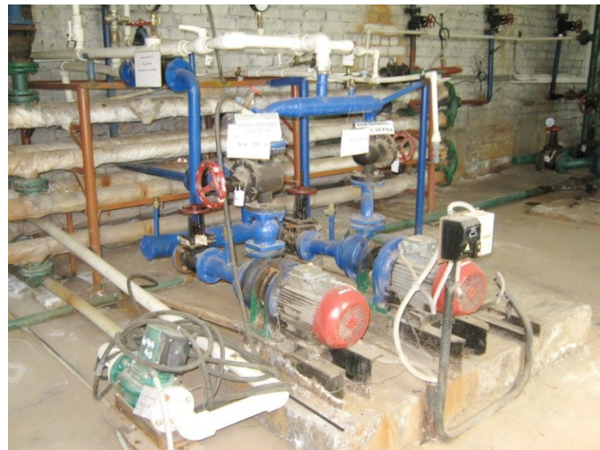
Рисунок 2.1.16 – Котельная д. Некрасово. Водоподогреватели.
