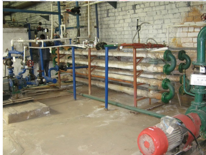
Рисунок 2.1.15 – Котельная д. Некрасово. Котлы КВН-1
