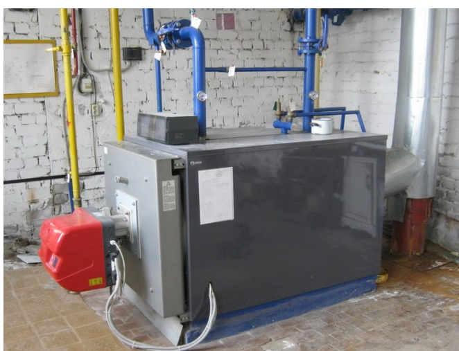
Рисунок 2.1.12 – Котельная с. Яковлевское. Сетевые насосы.
