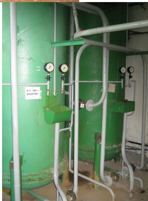
Рисунок 2.1.21 – Котельная с. Петрилово. Насосная группа
