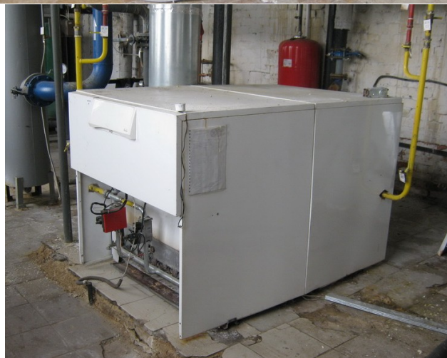
Рисунок 2.1.13 – Котельная с. Яковлевское. Котел Beretta Novella
