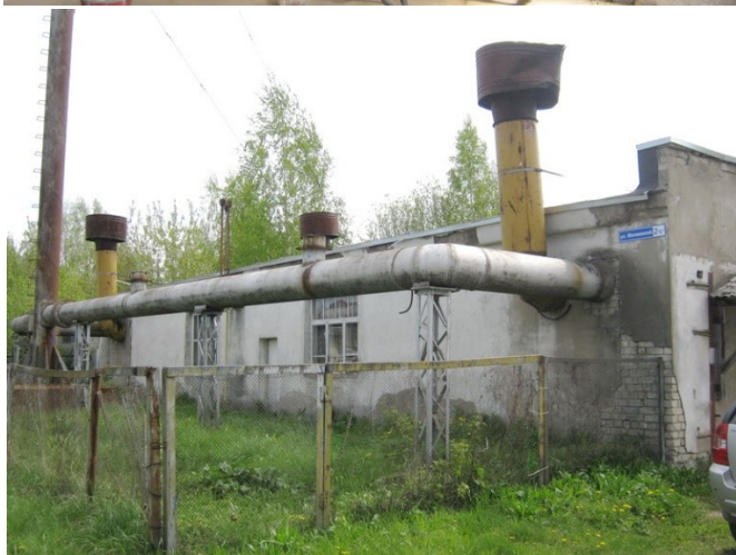
Рисунок 2.1.7 – Котельная с. Шунга. Водоподготовительная установка
