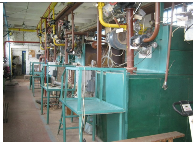
Рисунок 2.1.4 – Котельная с. Шунга. Котлы Братск 1Г
