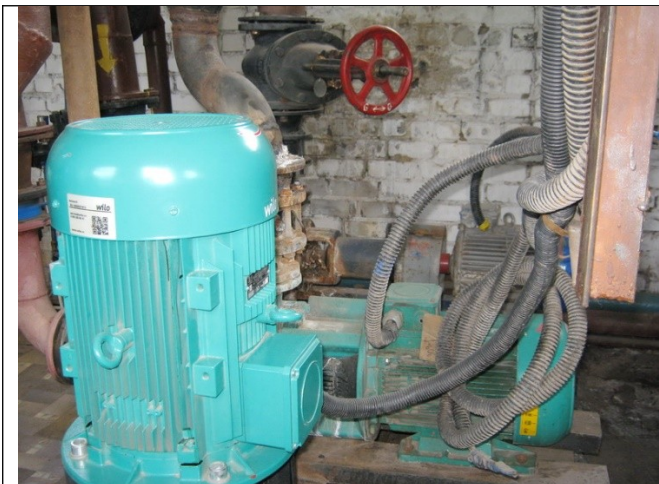
Рисунок 2.1.5 – Котельная с. Шунга. Сетевые насосы
