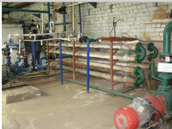
Рисунок 2.1.16 – Котельная д. Некрасово. Водоподогреватели.
