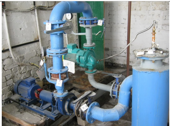
Рисунок 2.1.12 – Котельная с. Яковлевское. Сетевые насосы.
