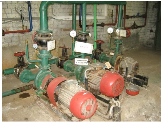
Рисунок 2.1.18 – Котельная д. Некрасово. Сетевые насосы.
