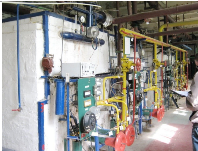
Рисунок 2.1.15 – Котельная д. Некрасово. Котлы КВН-1
