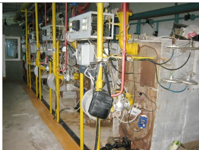
Рисунок 2.1.20 – Котельная с. Петрилово. Котлы Факел Г.
