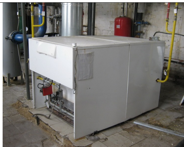
Рисунок 2.1.14 – Котельная с. Яковлевское. Котел Riello RTQ 418
