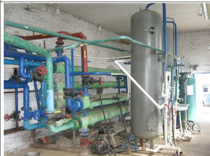
Рисунок 2.1.7 – Котельная с. Шунга. Водоподготовительная установка
