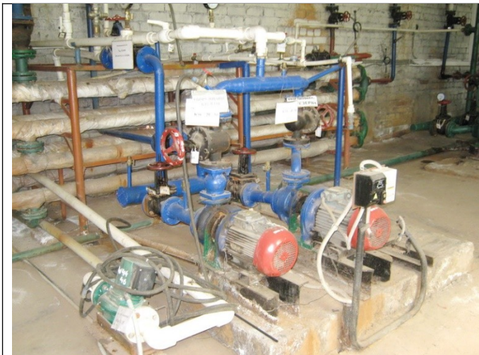
Рисунок 2.1.17 – Котельная д. Некрасово. Насосы ГВС.
