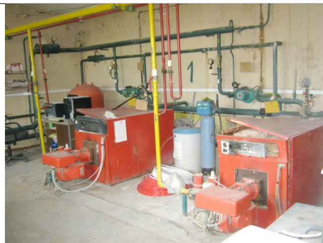
Рисунок 2.2.2 – Котельная школы с. Шунга. Котлы Kallard VR-12
