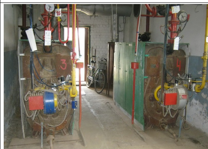
Рисунок 2.1.9 – Котельная с. Саметь. Котлы Факел Г.
