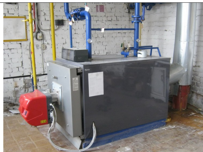
Рисунок 2.1.13 – Котельная с. Яковлевское. Котел Veretta Novella
