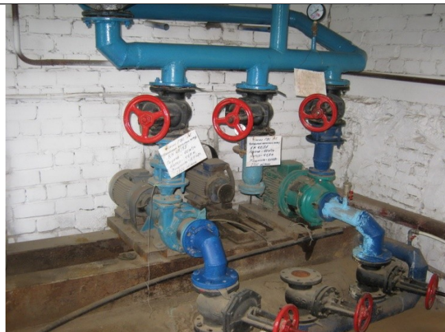
Рисунок 2.1.6 – Котельная с. Шунга. Насосы ГВС
