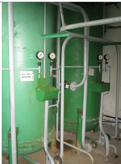
Рисунок 2.1.22 – Котельная с. Петрилово. Фильтры ВПУ
