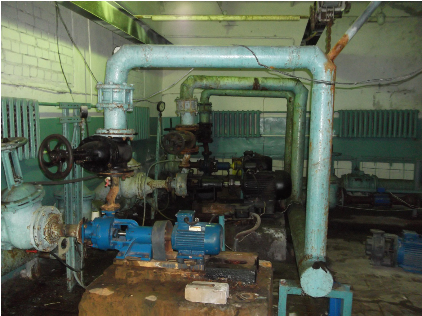
Станция второго подъема Рис. 3 – Станция водоснабжения с. Яковлевское
