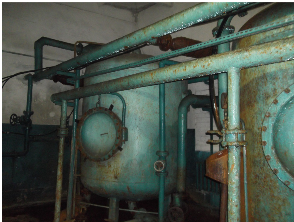
Станция обезжелезивания (внутреннее расположение) Рис. 2 – Станция водоснабжения с. Яковлевское
