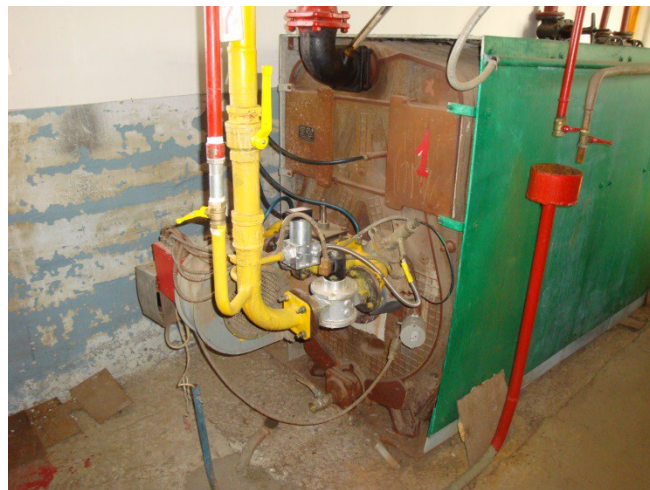
Фото 1.2.2 – котельная с. Саметь, котел КВА-1,0
