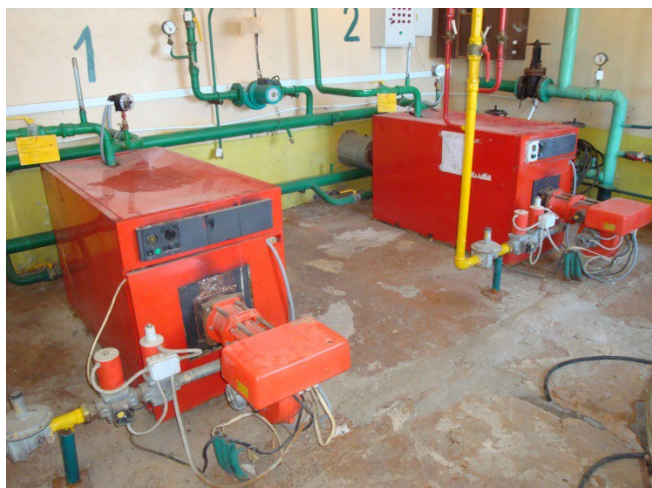
Фото 1.2.9 – котельная с. Шунга, котлы Kallard VR - 12
