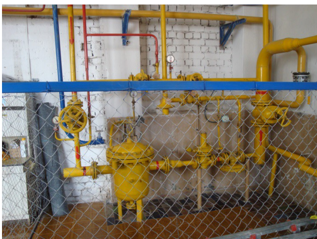
Фото 1.2.3 – котельная с. Яковлевское, ГРП
