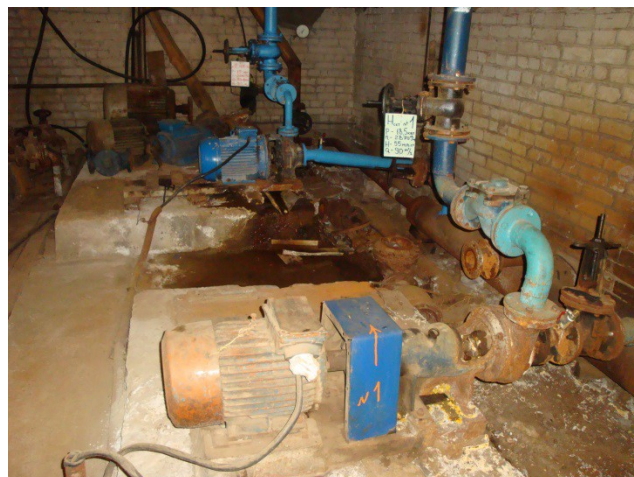
Фото 1.2.6 – котельная с. Саметь, сетевые насосы
