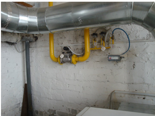
Фото 1.2.5 – котельная с. Яковлевское, узел учета газа
