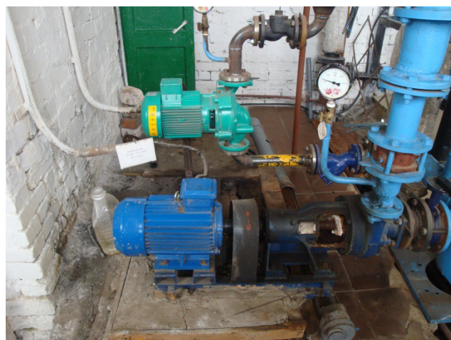
Фото 1.2.4 – котельная с. Яковлевское, сетевые насосы
